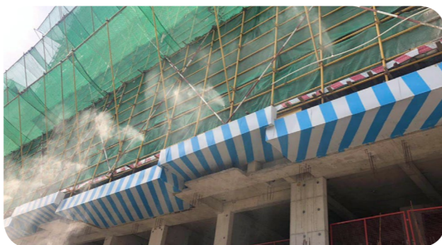
▲ 项目现场喷淋装置
